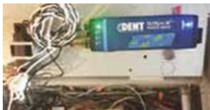
ヒートポンプに設置されたパワーメーターは、別途、DCSEU が監視。
